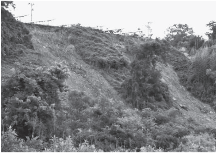
がけ崩れのあった県道（西荒屋）
