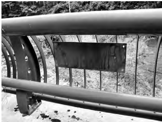
(写真：石川県内での被害例)
