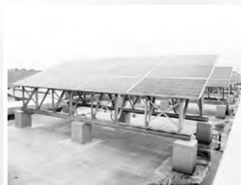
向栗崎小学校に設置された 太陽光発電パネル
