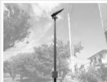
指定避難所等に設置された 太陽光発電式避難誘導灯
