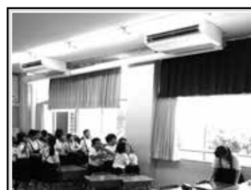
小学校空調設備
