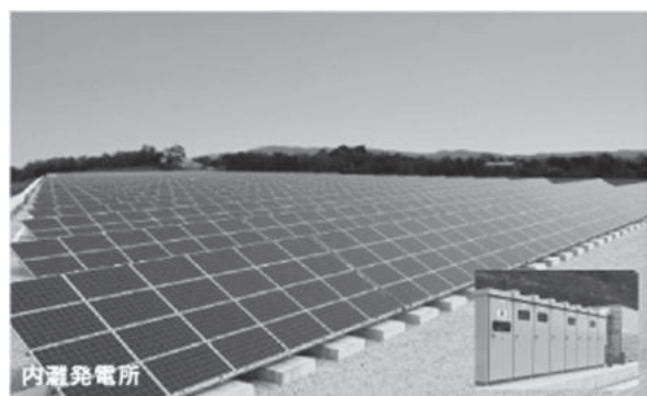
町の貸している土地に設置された太陽光発電所
