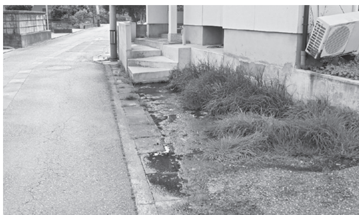
湧水による住環境の悪化（大根布地区）
