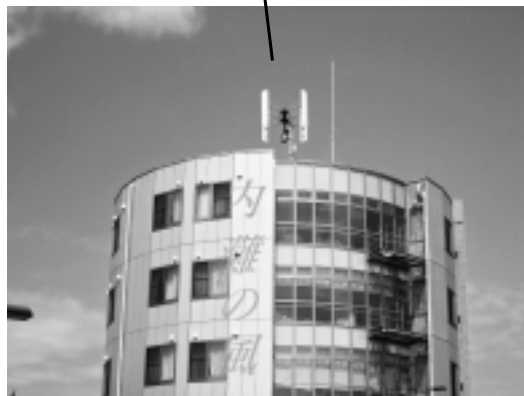
大根布地内に設置されている風力発電機器
