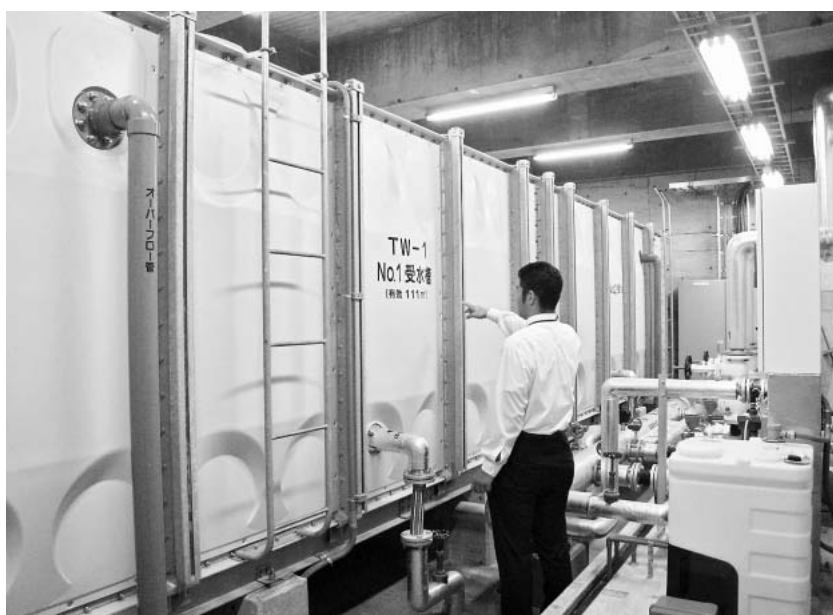
役場に設置されている貯水槽
