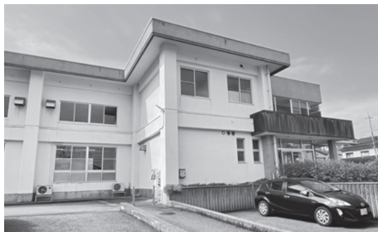
建物の劣化が心配
