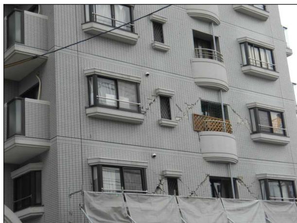
50104 【外部仕上】 大きなひび割れ又は仕上の剥離が見られる。
