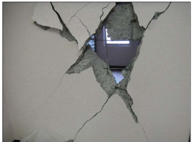
【鉄筋コンクリート造】 大きなひび割れが生じ、内部のコンクリートも崩れ落ち、壁の向こうが透けて見える。
