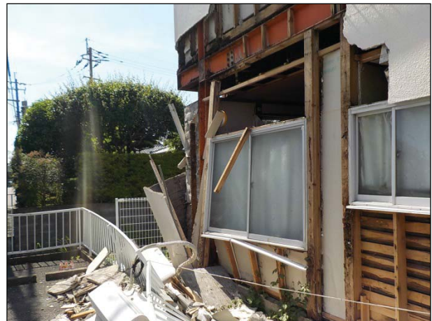
【アルミサッシ】 枠ごと外れて破壊されている。
