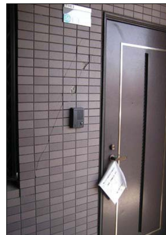
【雑壁】 各所にひび割れ(幅約0.2mm~1mm)やはがれが生じている。
