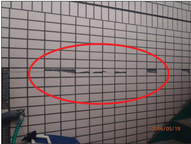
【外部仕上】 仕上材のわずかな剥離、目地のずれが見られる。
