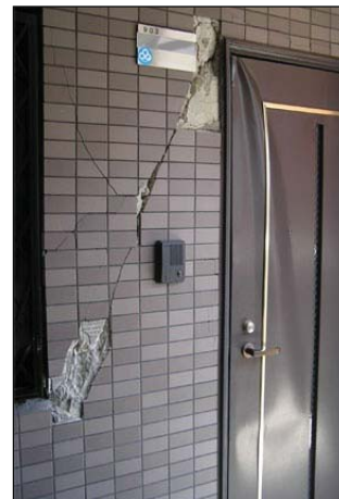
【雑壁】 全体にひび割れ(幅約0.2mm~1mm)やはがれが生じている。
