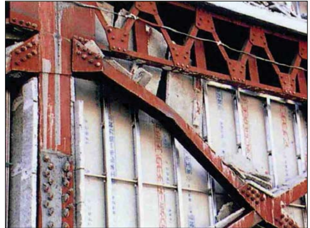
【鉄骨造】 50023 座屈変形が見られる。
