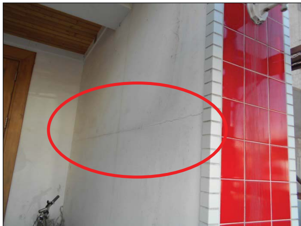
50095 【外部仕上】 仕上げや仕上材の目地にわずかなひび割れ(幅約0.2mm)が見られる。
