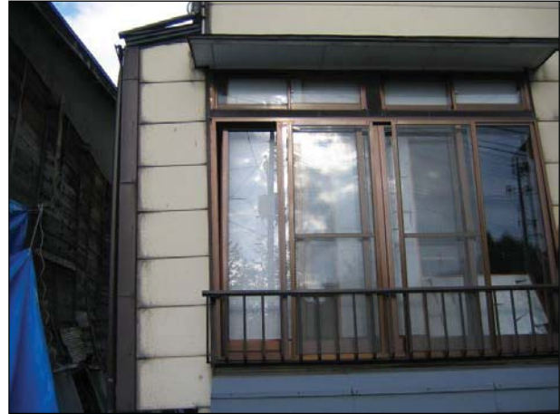
【アルミサッシ】 可動部が全損しており、枠の一部に変形が見られる。
