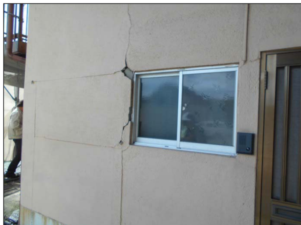
50100 【外部仕上】 仕上やパネルの目地にはっきりとしたひび割れが見られる。仕上材が部分的に剥離している。
