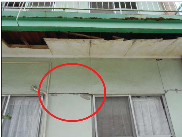
【外部仕上】 仕上材が部分的に剥離している。
