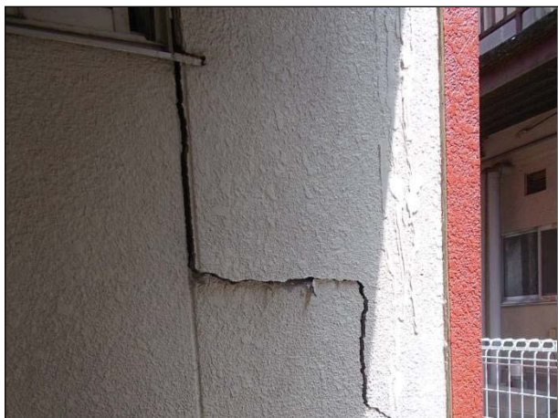
50099 【外部仕上】 仕上やパネルの目地にはっきりとしたひび割れが見られる。仕上材が部分的に剥離している。
