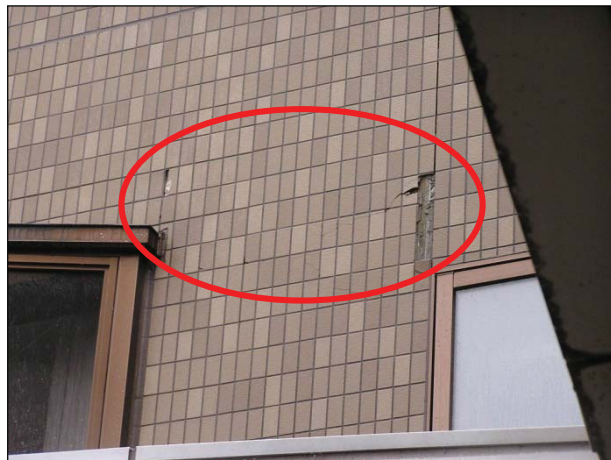
50096 【外部仕上】 仕上材のわずかな剥離、目地のずれが見られる。
