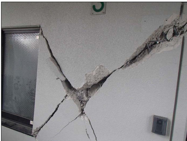
【鉄筋コンクリート造】 鉄筋が大きく露出しており、鉄筋の曲がり・破断が見られる。
