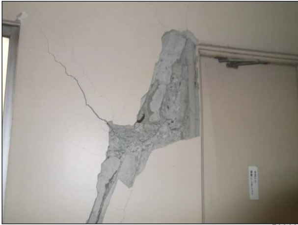
【鉄筋コンクリート造】 大きなひび割れ(2mmを超える)が多数生じ、コンクリートの剥落も激しい。鉄筋が露出しているものの鉄筋の変形は見られない。
