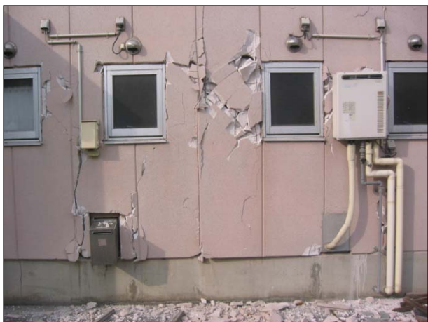
50103 【外部仕上】 大きなひび割れ又は仕上の剥離が見られる。
