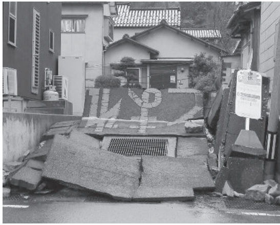
液状化による被害
