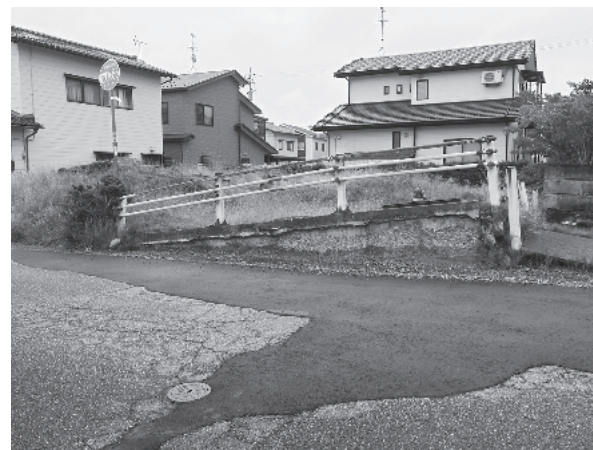
液状化で隆起した防火水槽（大根布）
