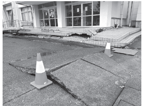
西荒屋小学校の被災状況
