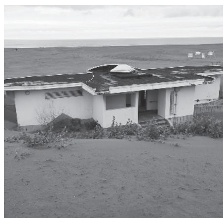
改修が急がれる公衆トイレ(内灘海水浴場)
