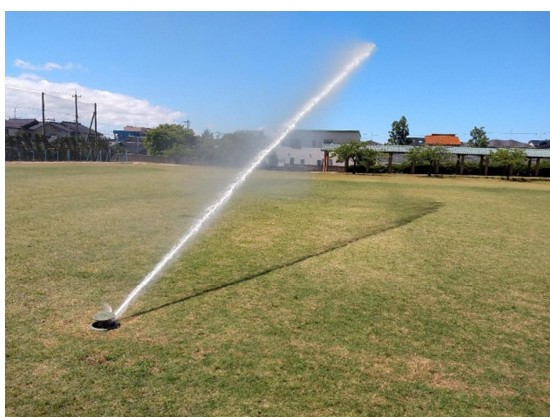
【清湖小学校散水設備】
