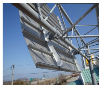
写真4 損傷(標識板変形)(裏)
